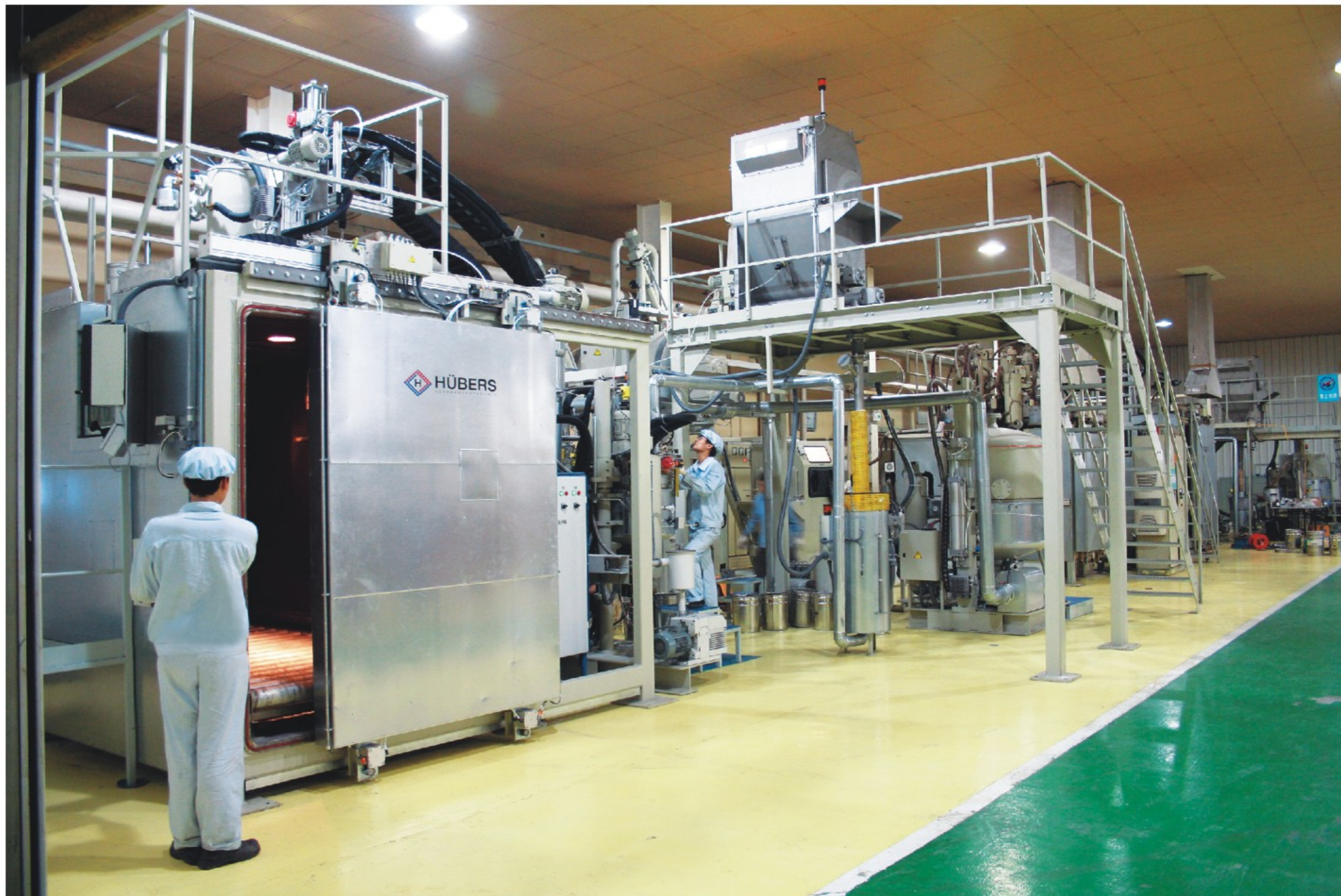
■ Введение линии производства для заливки изолятора эпоксидных смол, Германия
