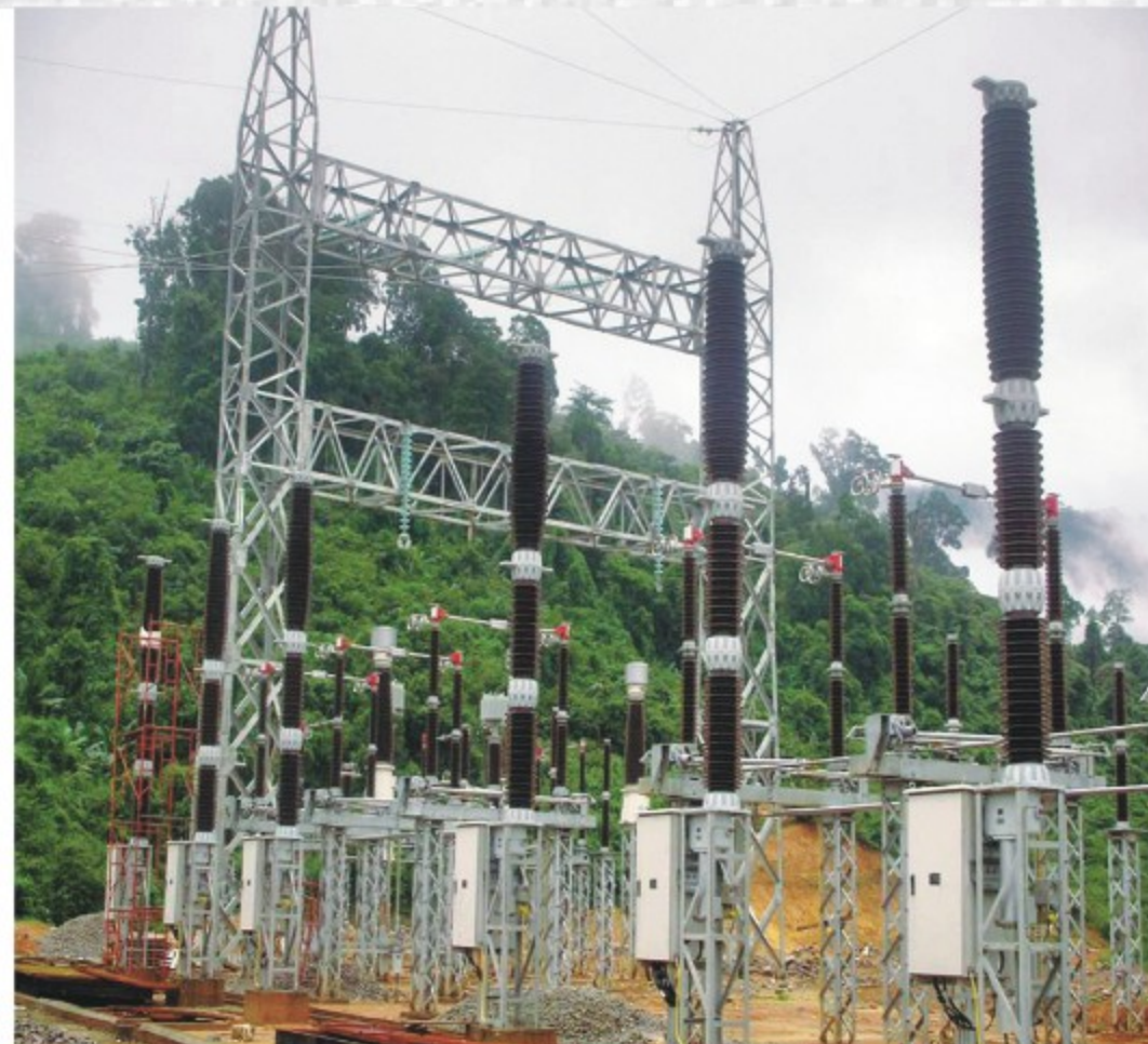
■ Колонковый выключатель типа LW35-252T в эксплуатации
