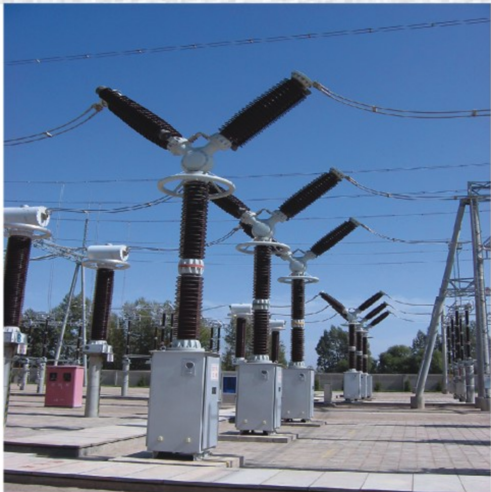
■ Колонковый выключатель типа LW10B-363 в эксплуатации
