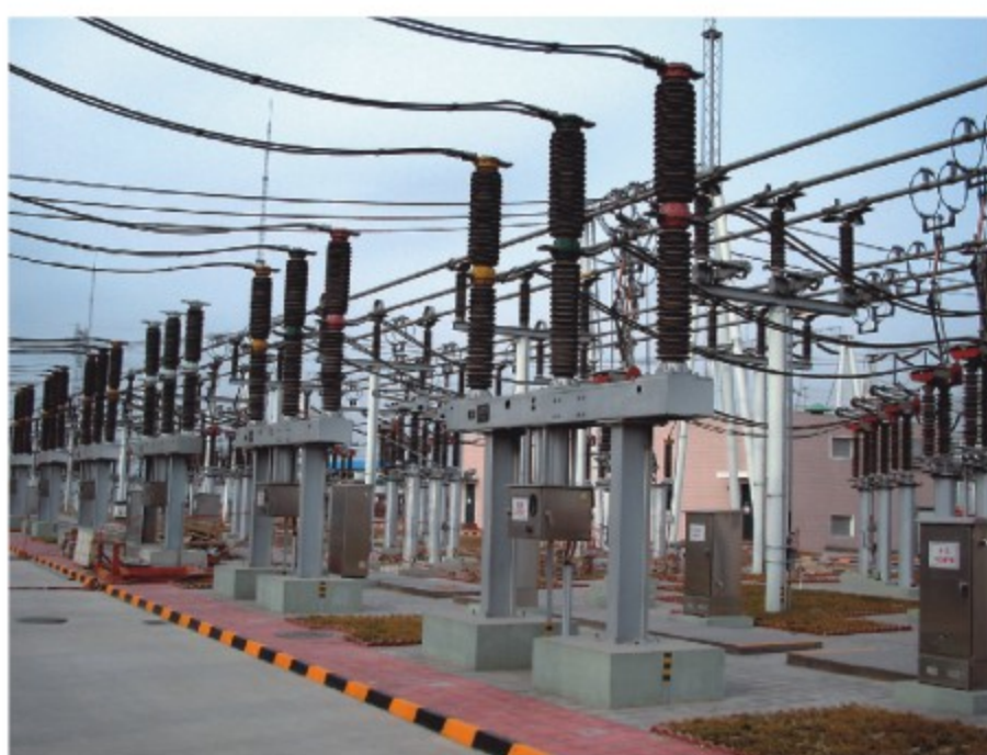
■ Колонковый выключатель типа LW35-126 в эксплуатации
