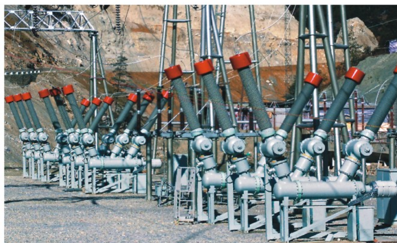
■ КРУЭ типа PASS ZHW1-252кВ в эксплуатации
