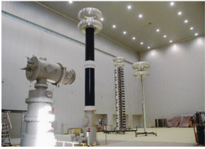
■ Испытательное оборудование на высокое напряжение
