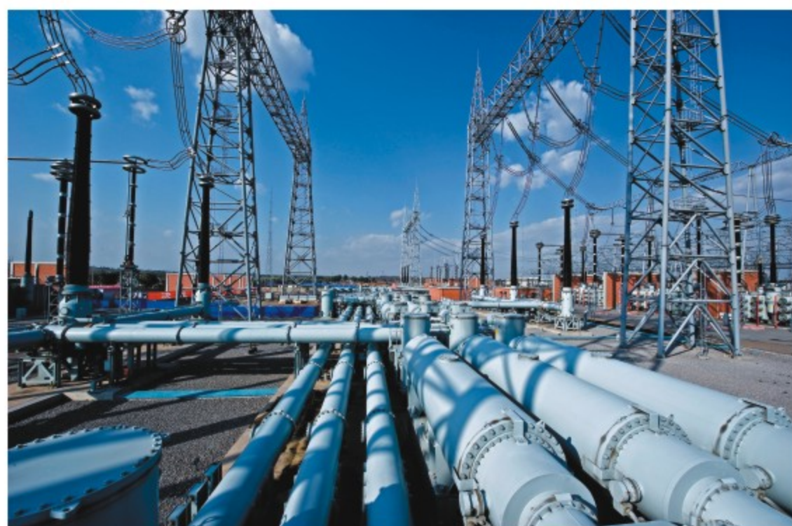
■ КРУЭ типа ZF27-1100 кВ в подстанции Цзиньдоннань, впервые в эксплуатации на напряжение 1100кВ в мире.
