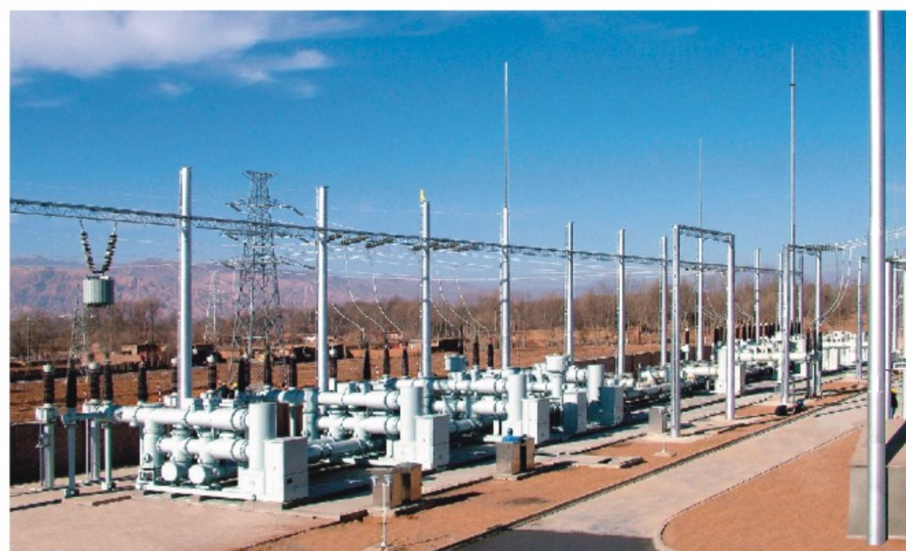
■ КРУЭ типа ZF12-126 кВ в эксплуатации
