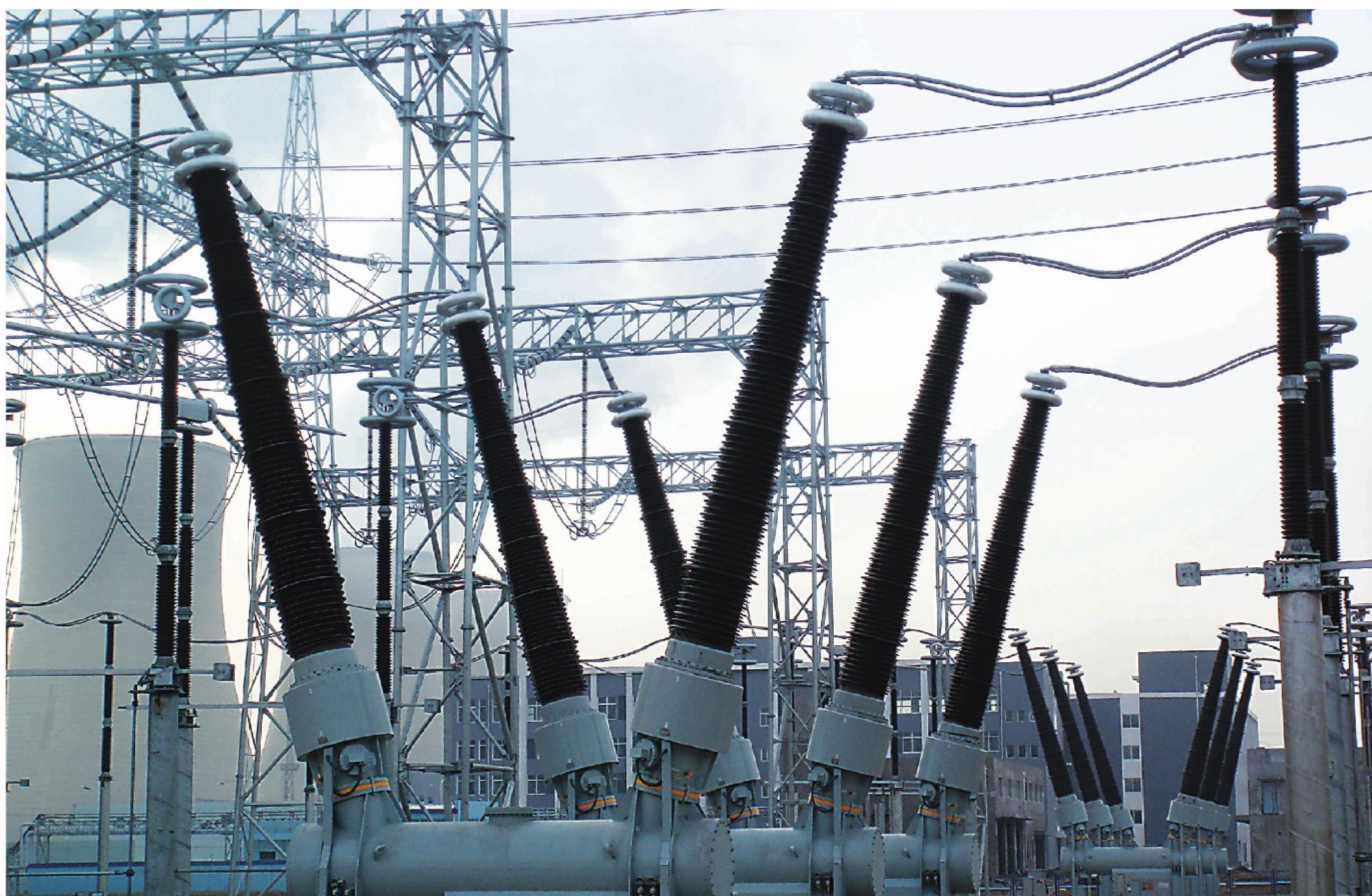
■ Выключатель элегазовый баковый типа LW55-800 в эксплуатации
