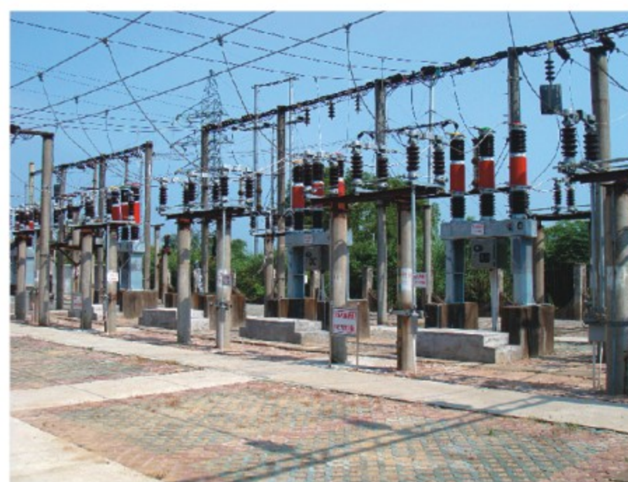
■ Колонковый выключатель типа LW34-40.5 в эксплуатации
