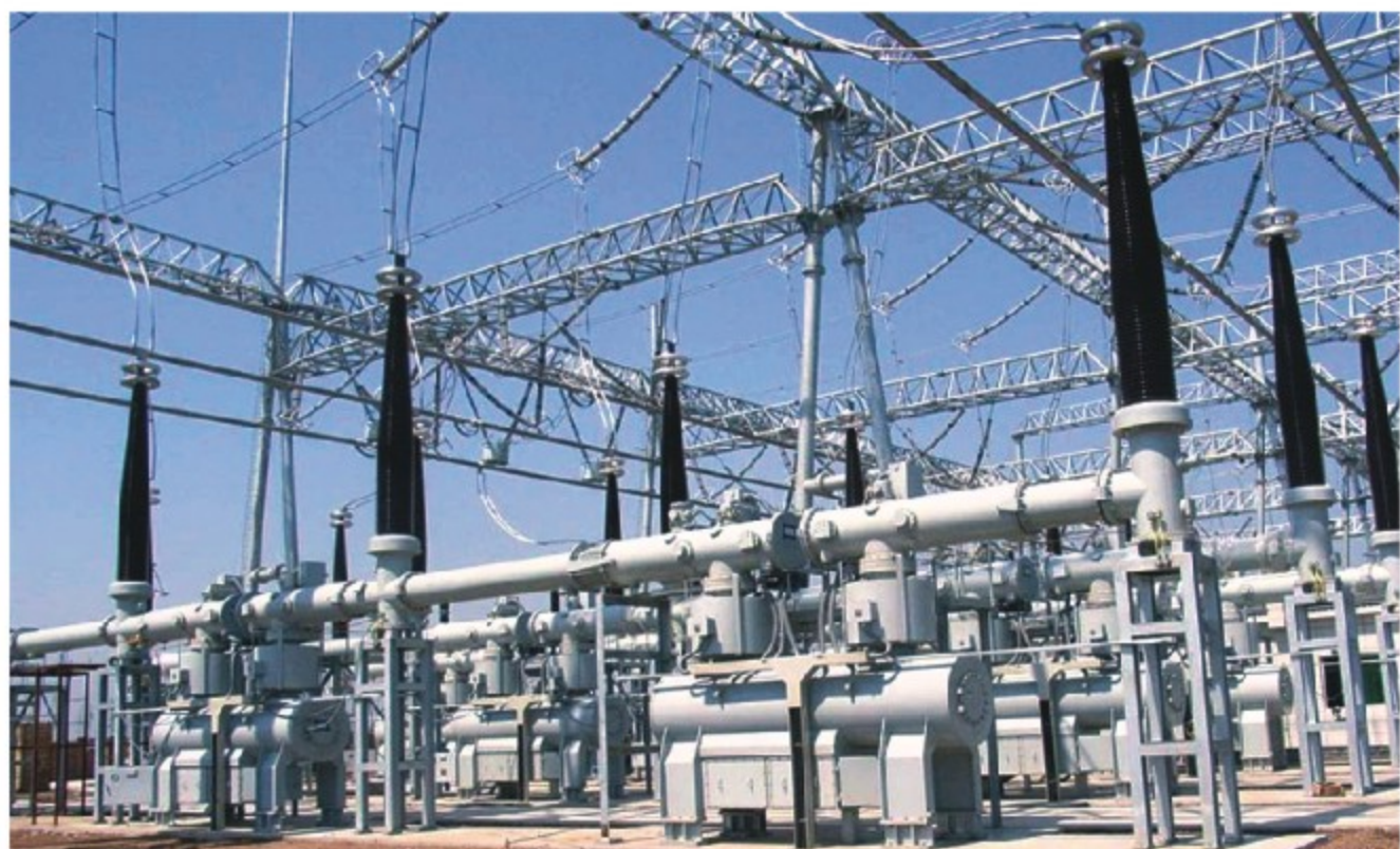
■ КРУЭ типа ZF27-550 кВ в эксплуатации
