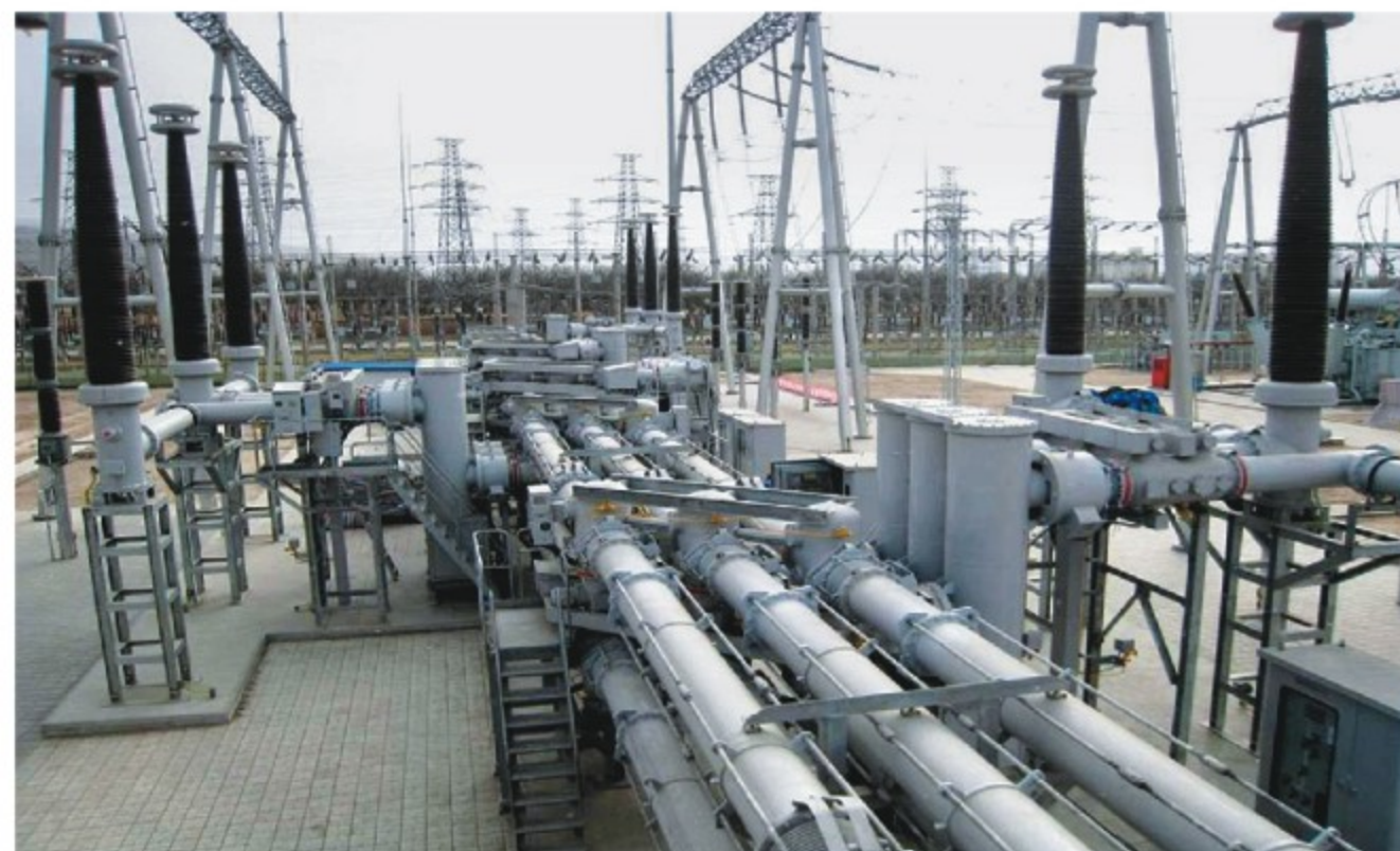
■ КРУЭ типа ZF27-363 кВ в эксплуатации
