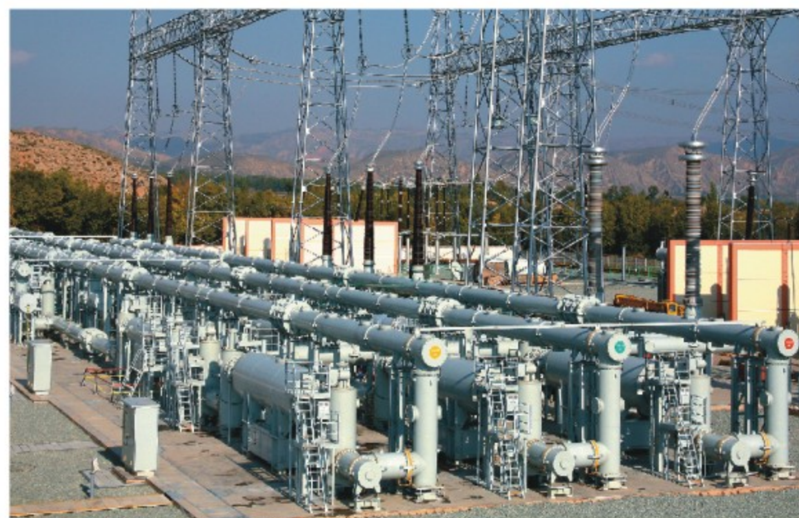
■ КРУЭ типа ZF27-800 кВ в эксплуатации
