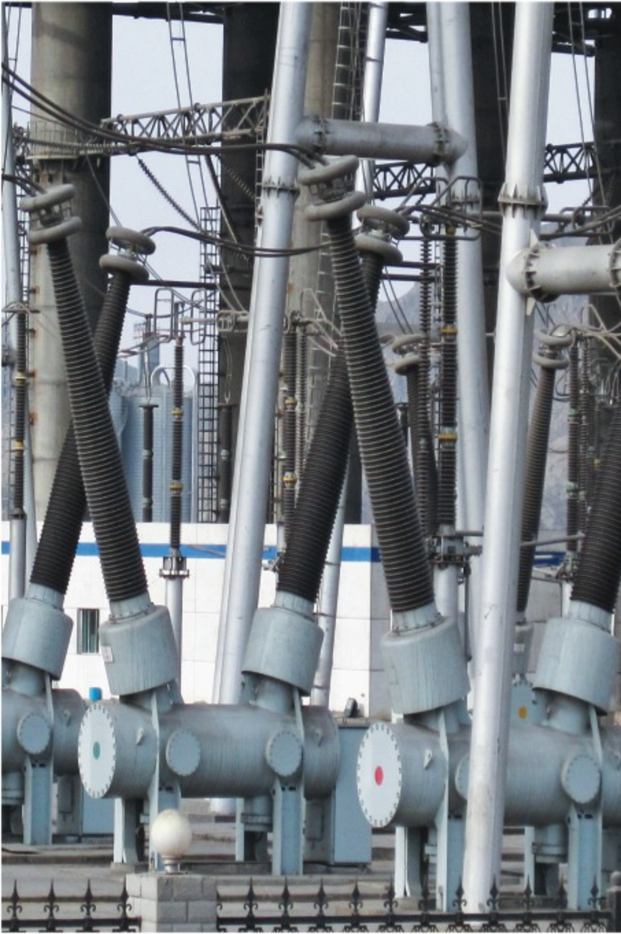
■ Выключатель элегазовый тбаковый типа LW55-550 в эксплуатации
