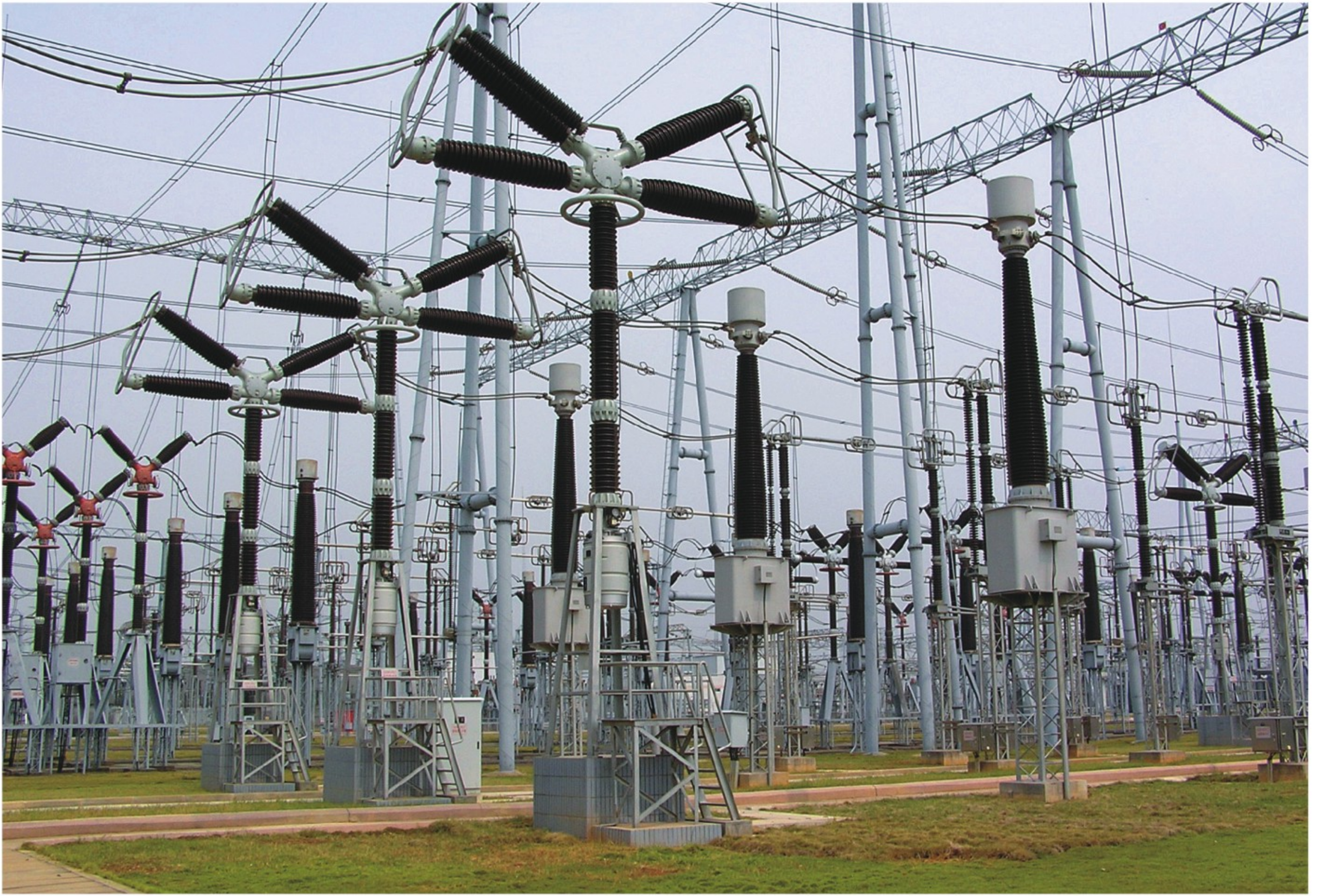
■ Выключатель типа LW10B-550 кВ в эксплуатации
