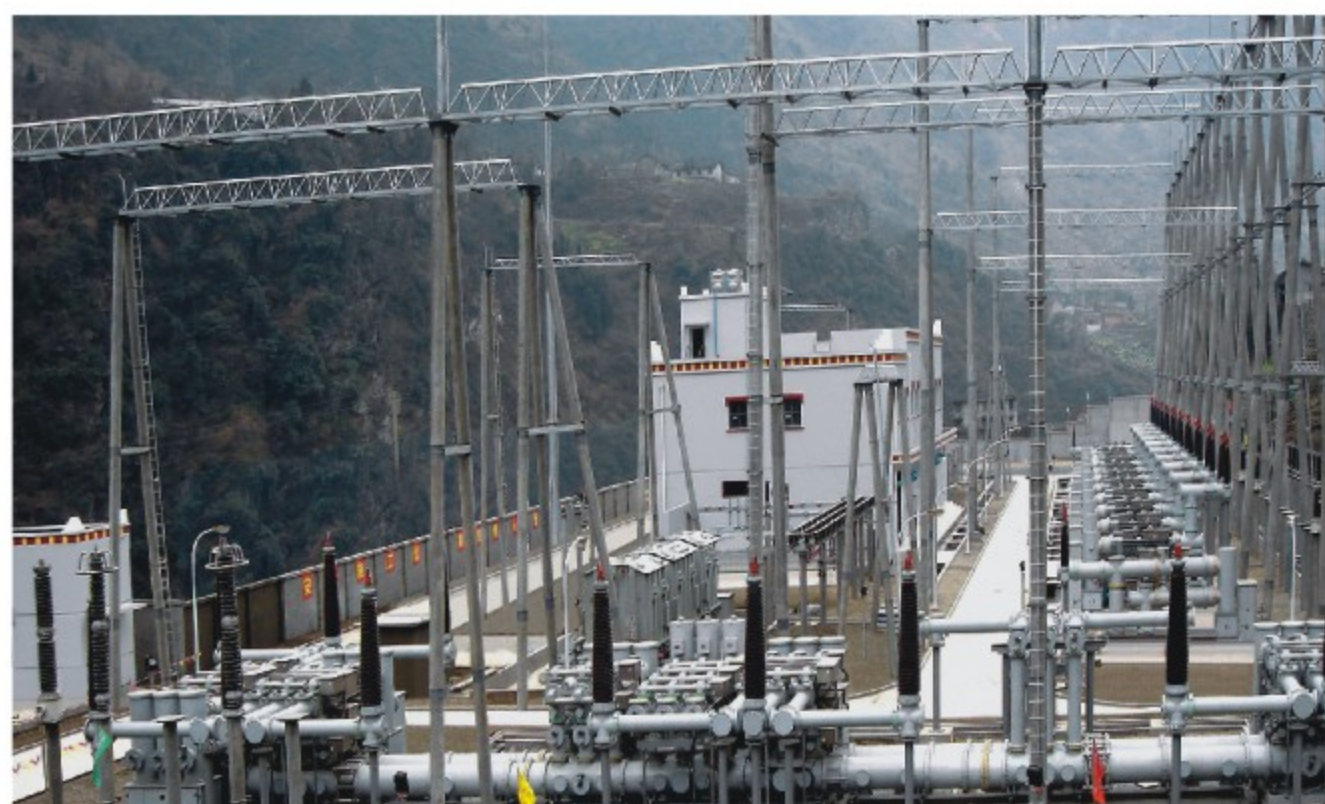
■ КРУЭ типа ZF11-252 кВ в эксплуатации
